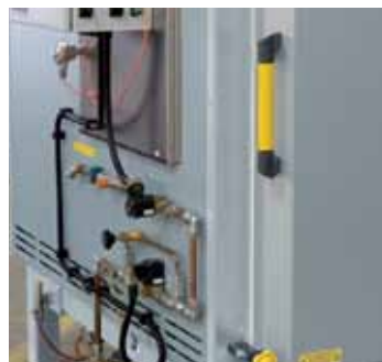
Газовое оборудование и термоэлемент в печи
